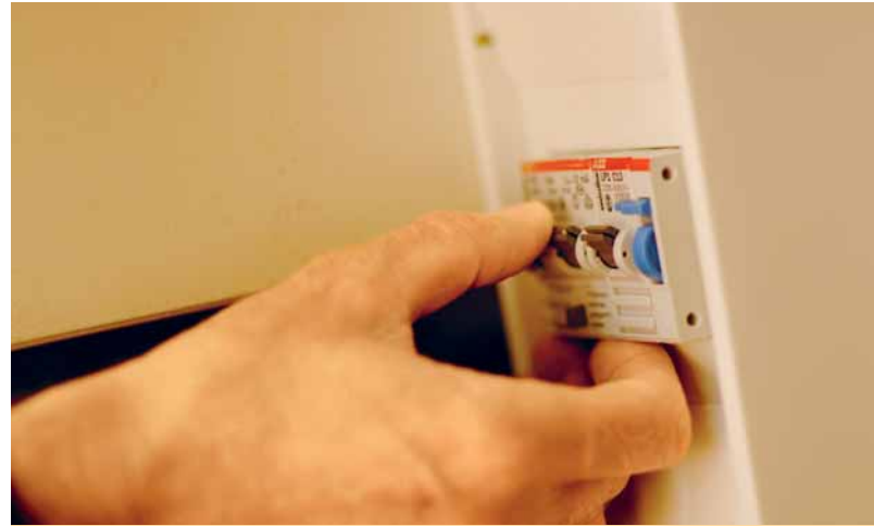
FI-Schutzschalter können auch in die bestehende Elektrohausinstallation eingebaut werden.
